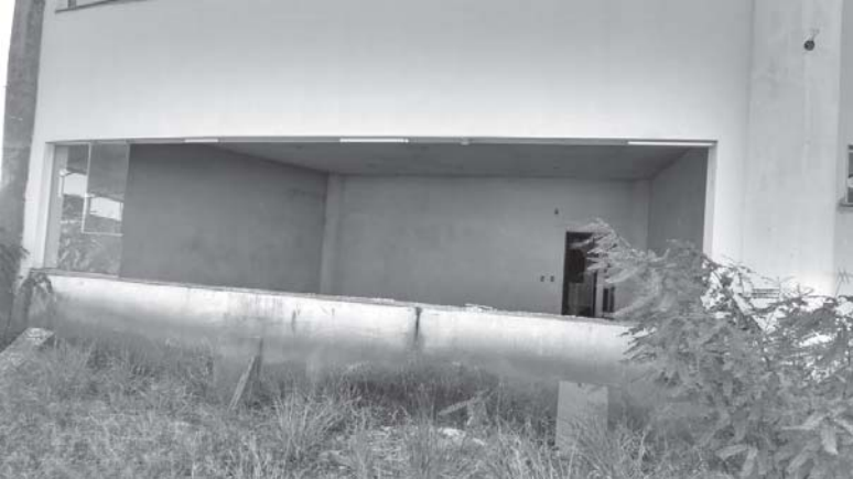
Vejam o tamanho do vão da janela da Escola em que os vidros foram quebrados por Vândalos
