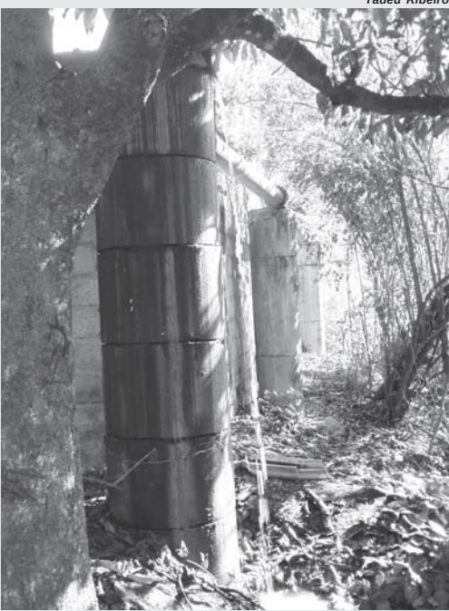
Caixa de recepção de rede de esgoto está vazando há mais de dois meses e espalha mal cheiro que incomoda moradores do Bairro Cidade Industrial
